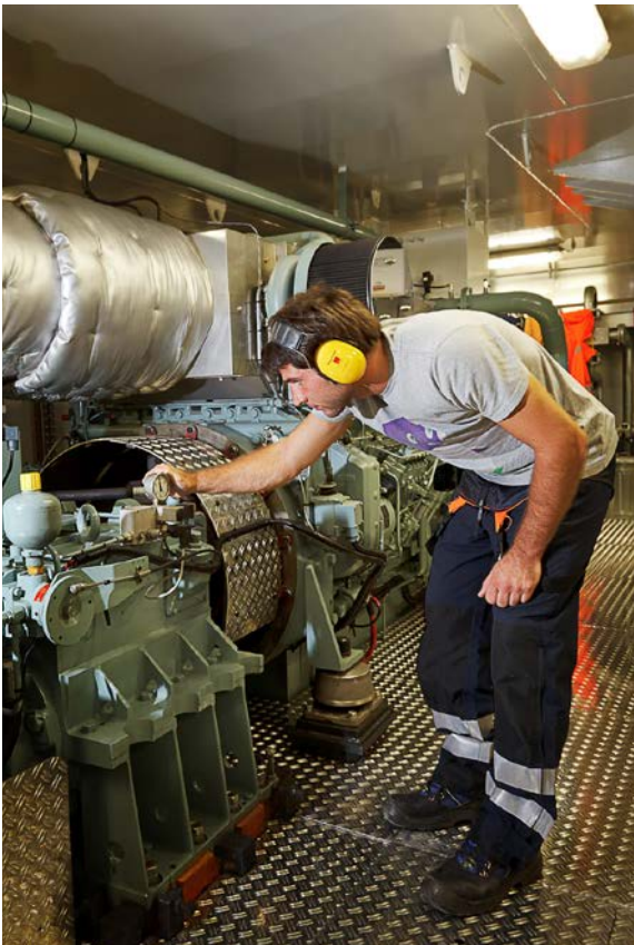
Abbildung 6: Überprüfen der Anlagen im Motorraum (Quelle: BDB, Platina-Projekt)
