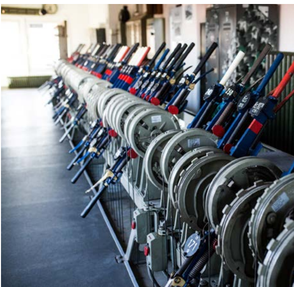
Abbildung 3: Signalhebel mechanisches Stellwerk (Quelle: Deutsche Bahn AG/Christin Gerstner)
