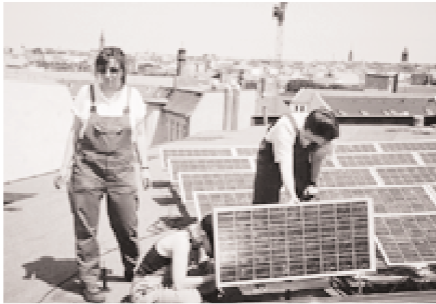
Auszubildende Dzenina bei der Installation einer Photovoltaikanlage auf dem Dach der Ausbildungswerkstatt
