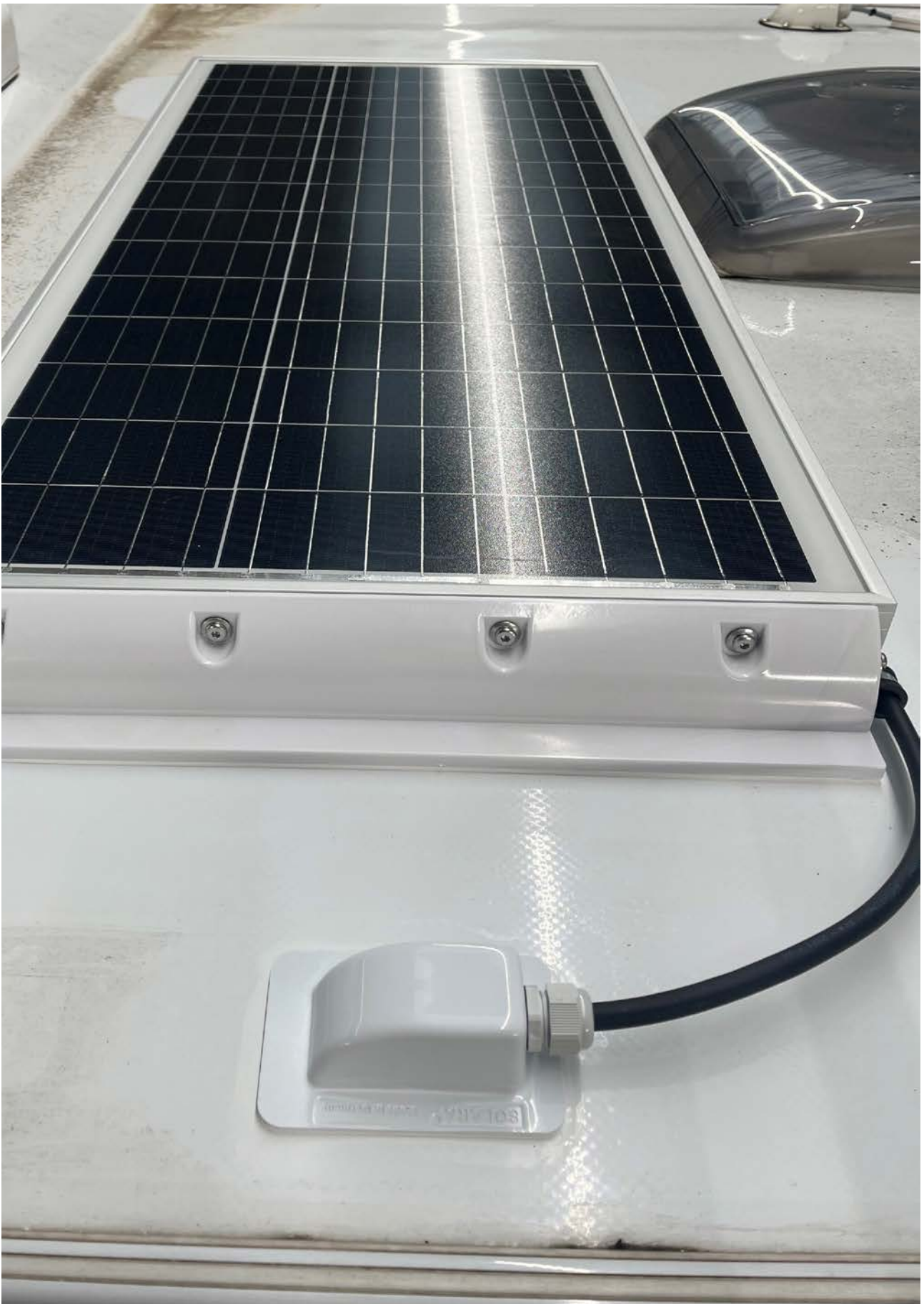
Abbildung 30: Nachgerüstete Solarpaneele zur Energiegewinnung auf einem Reisemobil (Quelle: ZKF)
