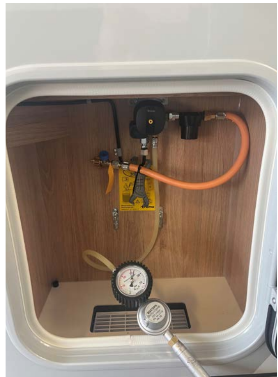
Abbildung 28: Druckprüfung an einer Flüssiggasanlage, welche zu Koch- und Heizzwecken in Caravans und Reisemobilen Verwendung findet (Quelle: ZKF)
