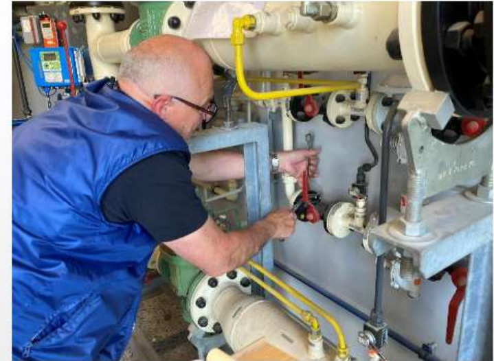
Probenentnahme in Station GDRMA für H 2 -Prüfungen
