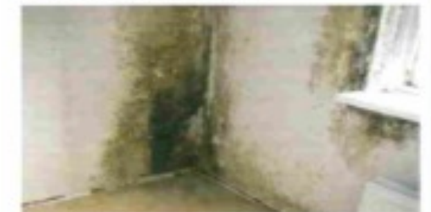
Beschaden in einem Innenraum (Schimmelbildung)
